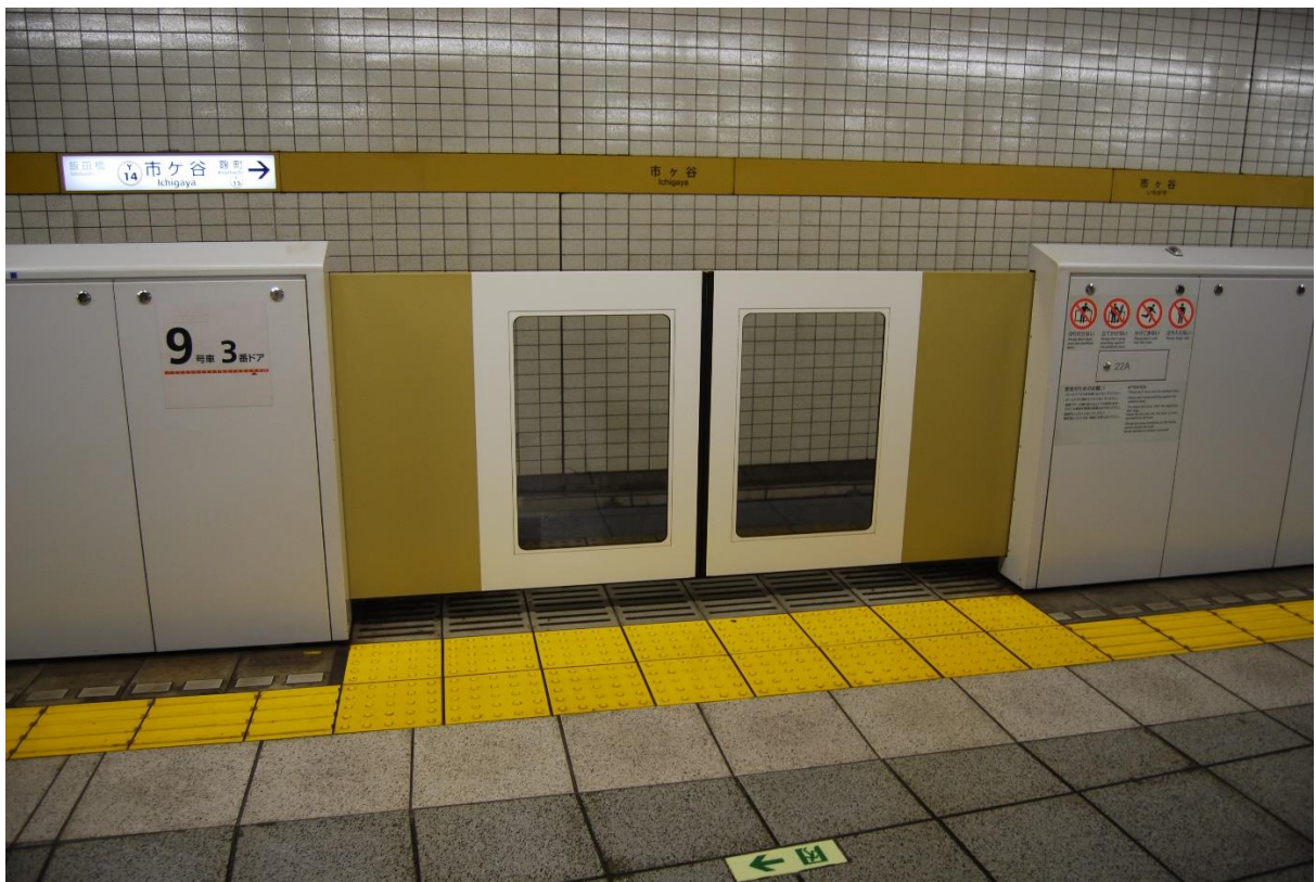
扉がガラスの場合のホームドア 有楽町線 市ヶ谷駅にて撮影
